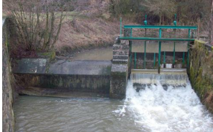
Ouverture d'un vannage (© J. Bouchard, OFB). A noter que, sur cet exemple, l'ouvrage semble toujours impossible à franchir pour des poissons en montaison.
