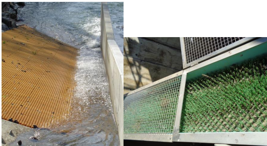
Exemples de substrats utilisés sur des rampes à anguilles : dalles à plots en élastomère (à gauche) et brosses en nylon (à droite) (© pôle écohydraulique, OFB)
