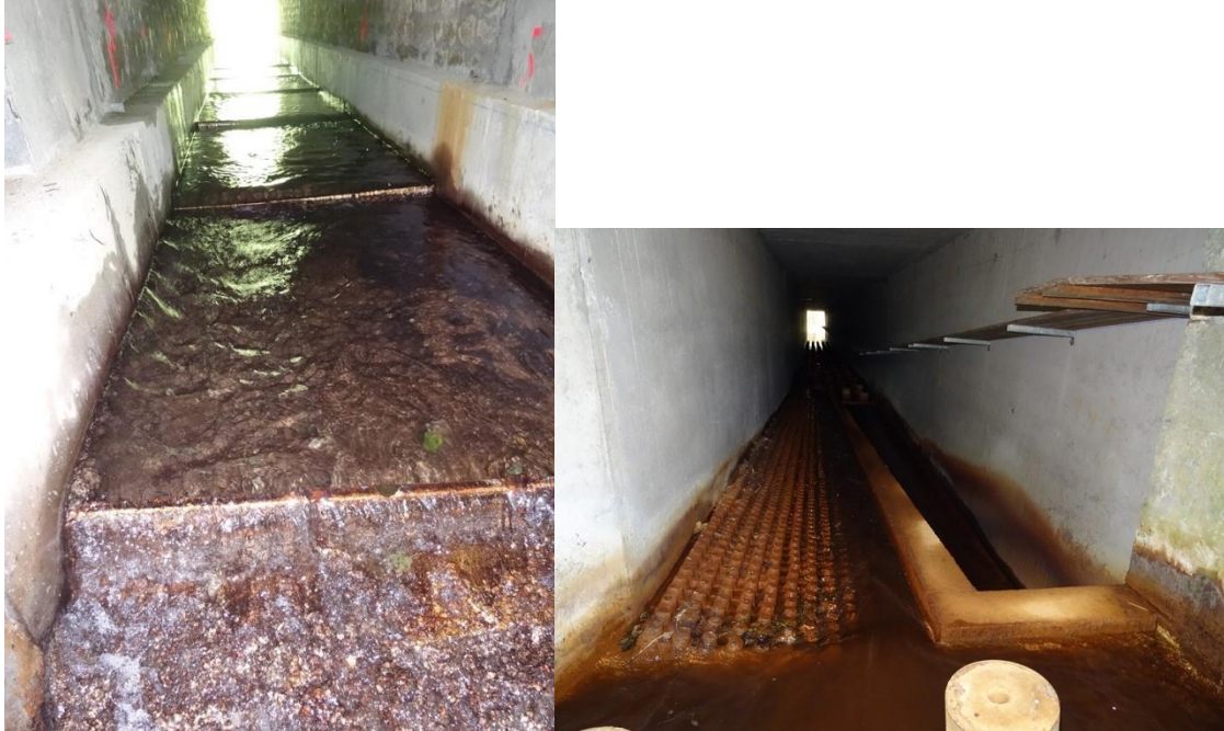
Ouvrages hydrauliques équipés : de barrettes (à gauche) et d'un substrat de reptation pour les anguilles (à droite) (© pôle échohydraulique, OFB)
